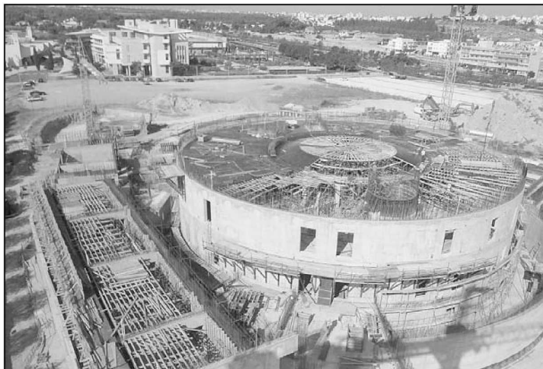
Το κτήριο, σε μορφή τεχνητού λόφου, είναι εμβαδού περίπου 15.700 τ.μ. και αναπτύσσεται κατακόρυφα σε 5 επίπεδα (υπόγειο, ισόγειο και τρεις ορόφοι).
