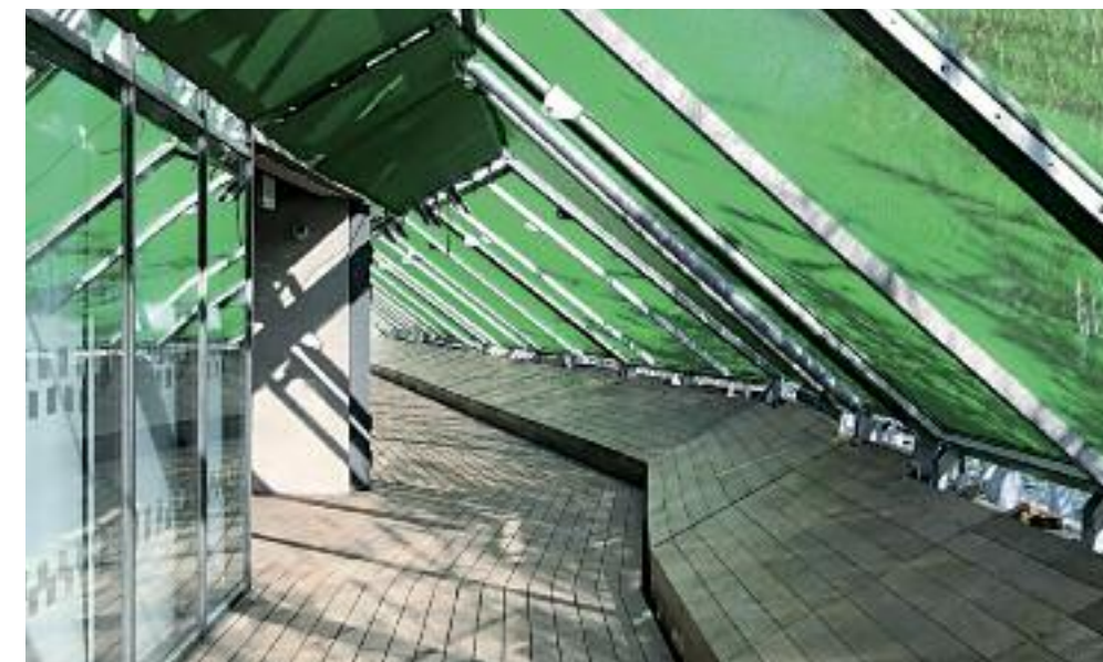
ΟΙ ΜΕΜΒΡΑΝΕΣ ΠΟΥ ΚΑΛΥΠΤΟΥΝ ΤΟ ΛΟΦΟ ΕΞΕΛΙΣΣΟΝΤΑΙ ΣΕ ΣΥΣΤΗΜΑ ΗΛΙΟΠΡΟΣΤΑΣΙΑΣ ΣΤΙΣ ΕΚΤΘΕΘΙΜΕΝΕΣ ΟΨΕΙΣ ΤΟΥ ΚΤΙΡΙΟΥ.
