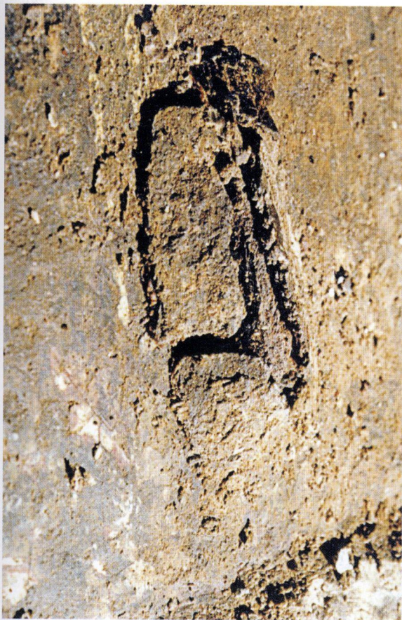
α. Ρωγματώσεις στο θεμέλιο.
